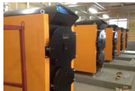
道志の湯の薪ボイラー
